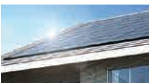
太陽光発電システム
